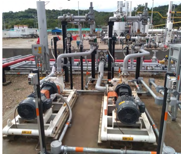
Figura 3. Bombas de despacho de GLP
