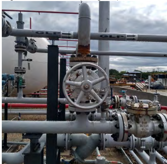
Figura 5. Válvula de recirculación.
