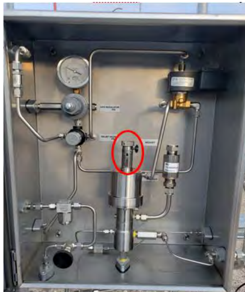
Figura 7. Sistema de dosificación de mercaptano
