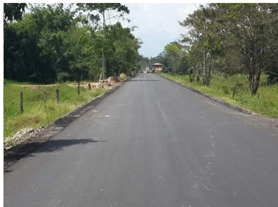
Fotografía 2-3 Ruta 3: Centro poblado de Saravena – Centro poblado La Esmeralda (Jujua) (Vía 14) – Tramo 1 Centro poblado de Saravena – Centro poblado el Fortul en buen estado
