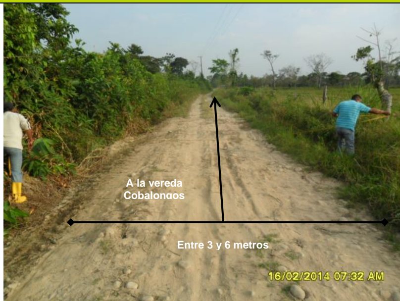
Fotografía 2-31 Mal estado de la vía K1+800, coordenadas 0927678E- 1267381N (magna –este)
