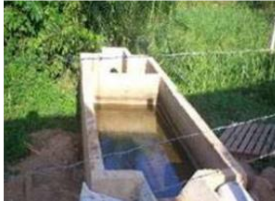
Fotografía 2-71 Desarenador convencional en concreto
