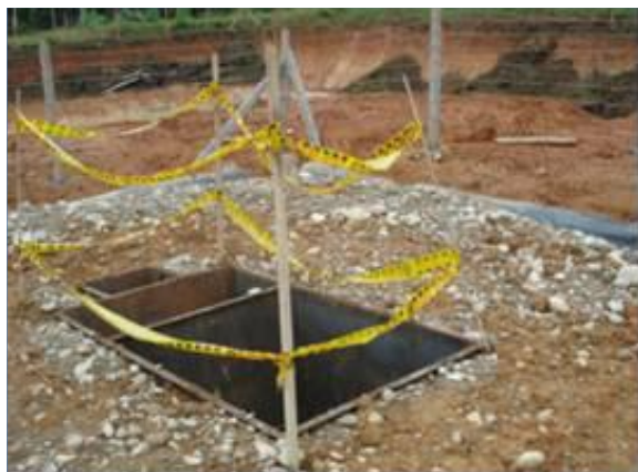
Fotografía 2-75 Skimmer portátil construido en lámina
