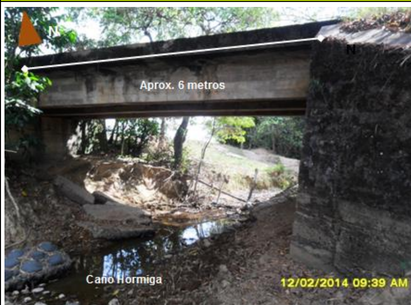
Fotografía 2-7 Pontón en buen estado sobre el Caño Hormiga, coordenadas 0930642E- 1263753N (magna –este)
