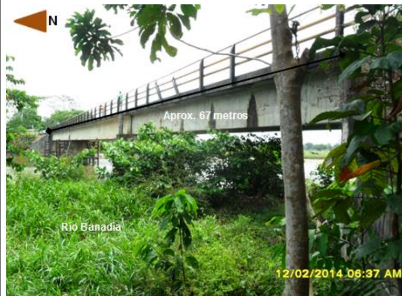
Fotografía 2-6 Puente en buen estado sobre el Río Banadía, coordenadas 0924719E- 1265890N (magna –este)
