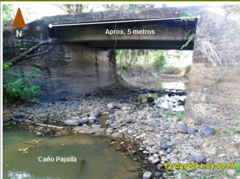
Fotografía 2-8 Pontón en buen estado sobre el Caño Pajuela, coordenadas 931456E- 1263231N (magna –este)
