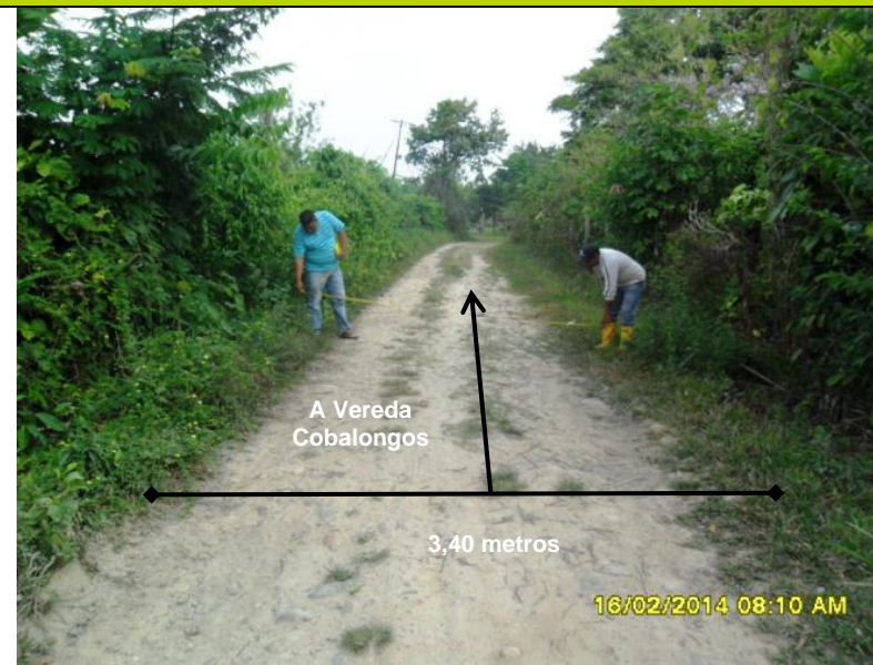
Fotografía 2-32 Regular estado de la vía K3+200, coordenadas 0927587E- 1268324N (magna –este)
