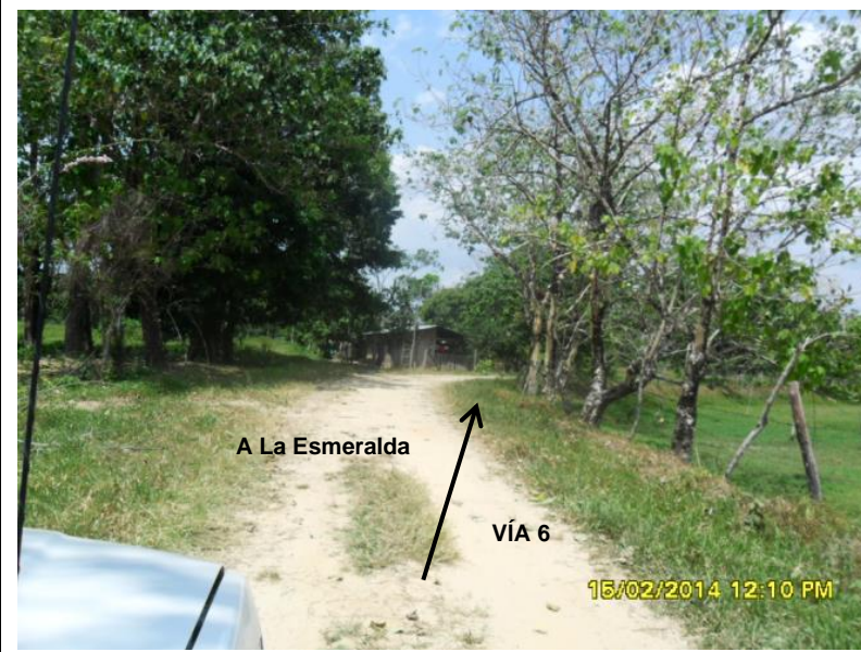
Fotografía 2-38 Mal estado de la vía K7+200, coordenadas 0936825E- 1267225N (magna –este)
