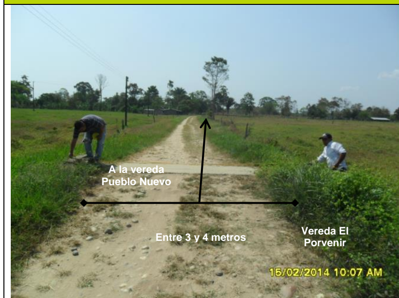
Fotografía 2-39 Regular estado de la vía K2+250, coordenadas 0933235E- 1262874N (magna –este)
