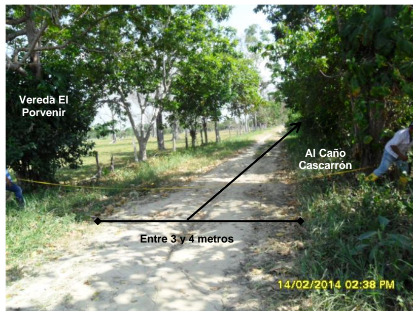
Fotografía 2-43 Mal estado de la vía K0+500, coordenadas 0935839E- 1264944N (magna –este)
