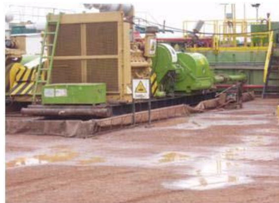
Fotografía 2-74 Equipos ubicados sobre geomembranas con diques
