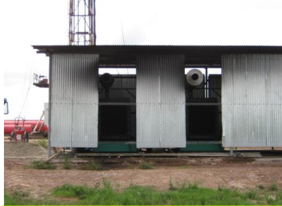
Fotografía 2-65 Caseta de generadores sobre patines de tubería.
