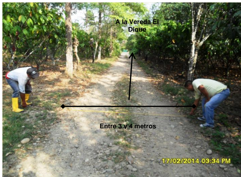
Fotografía 2-18 Regular estado de la vía K0+100, coordenadas 0919072E- 1271258N (magna –este)
