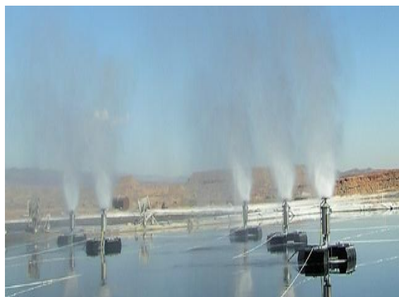
Fotografía 2-81 Panorámica de la operación de una evaporación mecánica
