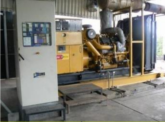
Fotografía 2-64 Área de Generadores típica.
