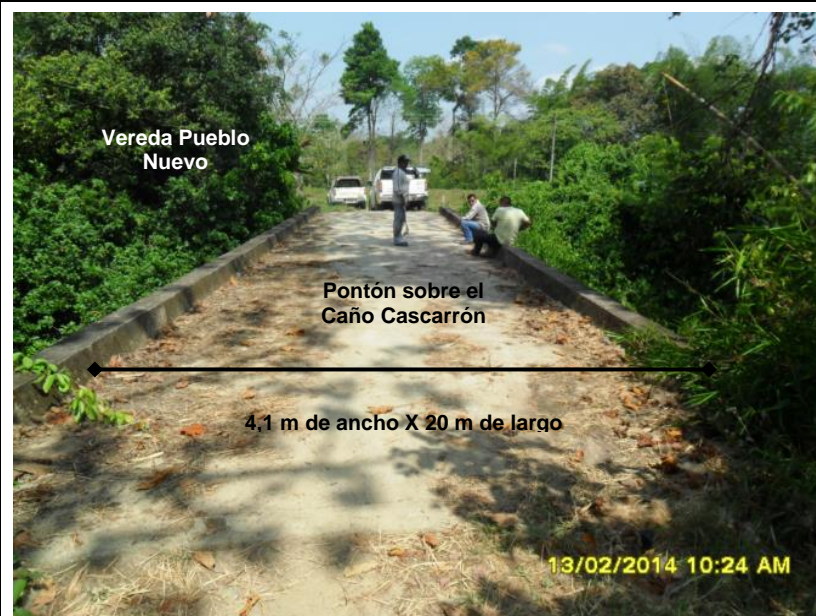
Fotografía 2-45 Pontón Caño Cascarrón buen estado K3+900, coordenadas 0934115E- 1268330N (magna –este)
