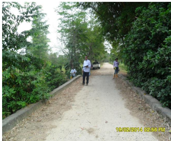
Fotografía 2-2 Ruta 2: Casco urbano de Saravena – Vereda Charo Centro (Vía 3-1) en buen estado
