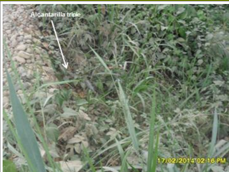
Fotografía 2-12 Alcantarillas saturadas en mal estado, coordenadas 0919324E- 1271051N (magna –este)
