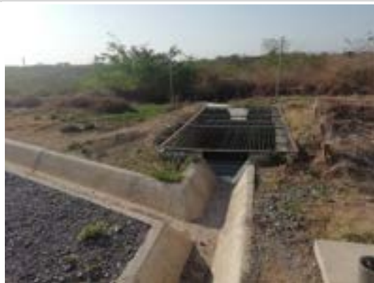
Fotografía 2.10 Cunetas y desarenador de aguas lluvias Fuente: PAREX, 2021.
