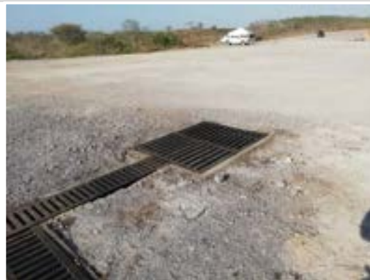
Fotografía 2.11 Cárcamo de aguas aceitosas Fuente: PAREX, 2021.
