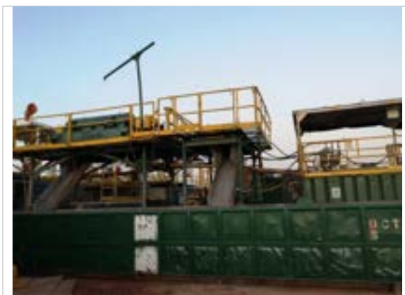
Fotografía 2.23 Equipos del sistema de control de sólidos
