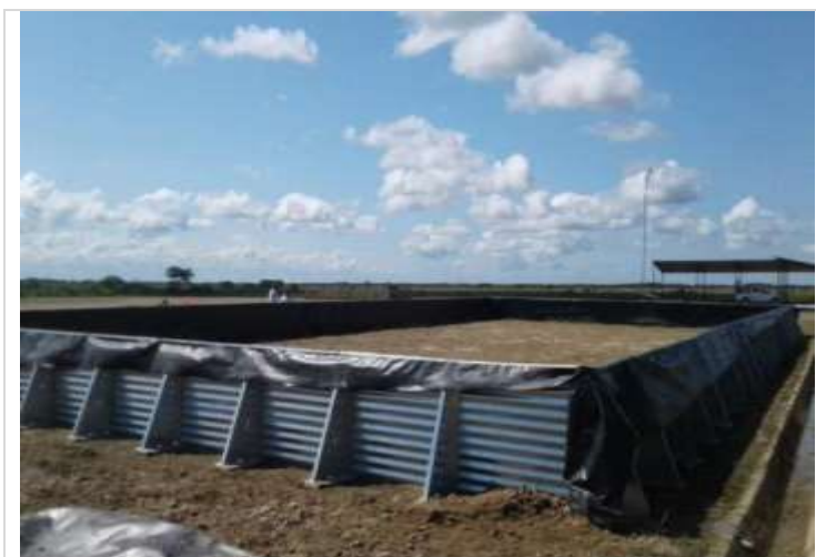
Fotografía 2.269 Dique para tanques de almacenamiento
