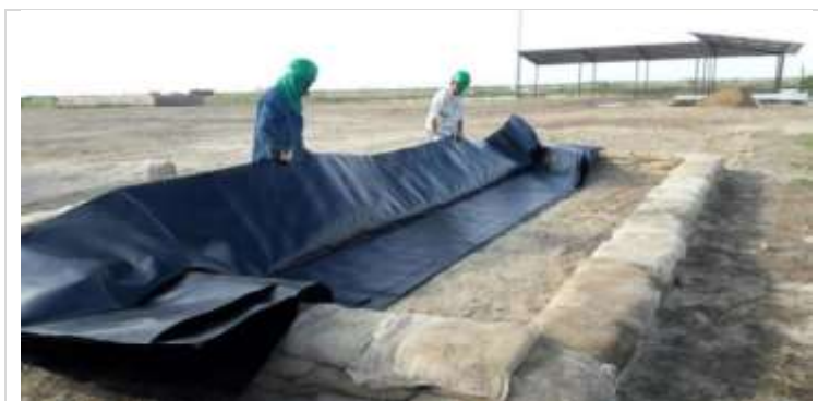
Fotografía 2.270. Dique para equipos auxiliares. Fuente: PAREX, 2020.
