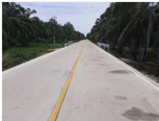
Fotografía 2.16. Estado de vía actual km 1+020. ESTE. 1071256. NORTE. 1345993. Fuente: ASI S.A.S., 2020.
