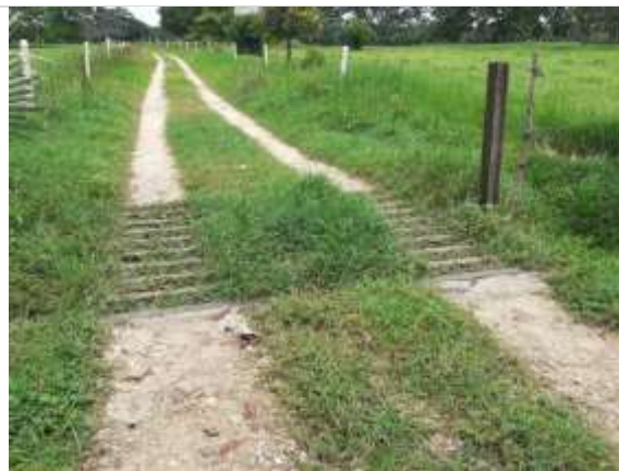
Fotografía 2.142 Queiebrapatas sobre la vía km 0+700 ESTE. 1068899 NORTE. 1333910 Fuente: ASI S.A.S., 2020.
