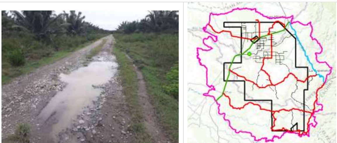
Fotografía 2.254. Estado actual vía Coordenadas: Este 1065744; Norte 1341962 Fuente: ASI S.A.S., 2020.
