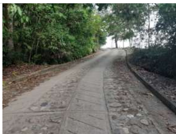
Fotografía 2.166 Huella en concreto km 3+400. ESTE. 1078428. NORTE. 1327450. Fuente: ASI S.A.S., 2020.
