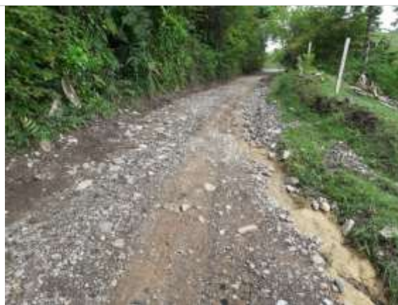
Fotografía 2. 2 Mal estado calzada km 23+800. ESTE. 1079385 NORTE. 1334803 Fuente: ASI S.A.S., 2020.
