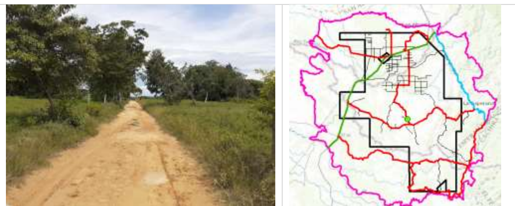
Fotografía 2.252 Estado actual vía. Coordenadas: Este 1071068; Norte 1334809 Fuente: ASI S.A.S., 2020.
