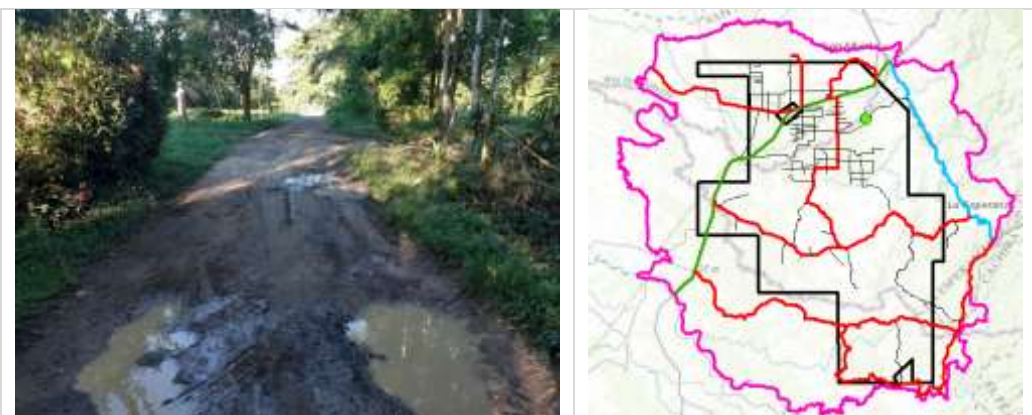
Fotografía 2.253. Estado actual vía Coordenadas: Este 1073950; Norte 1344958 Fuente: ASI S.A.S., 2020.
