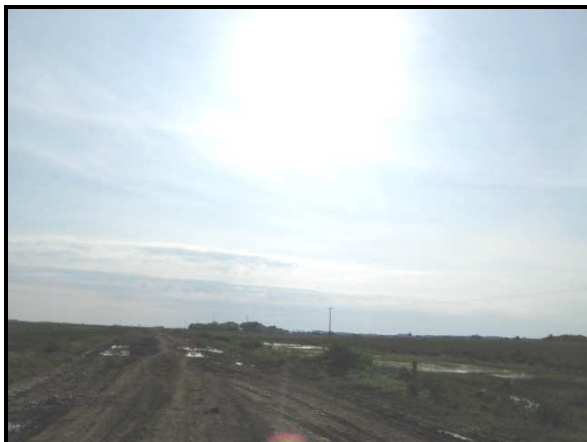
Fotografía 2.6 Algunos baches sobre la vía en el desvío hacia la veredas y la Palmita,.
