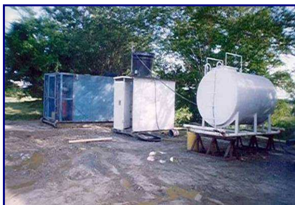
Fotografía 2.31 Batería Sanitaria y Tanque de Almacenamiento de Agua para Uso Doméstico.
