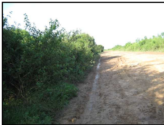
Fotografía 2.5 Algunos tramos de la vía presentan buenas condiciones conservación y el requerimiento para su mantenimiento es menor.
