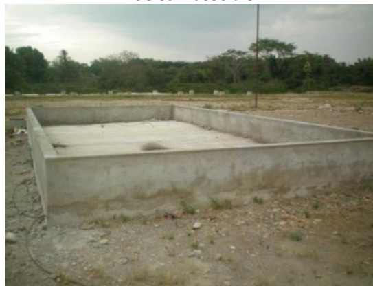
Fotografía 2- 97 Vista área de almacenamiento de combustible
