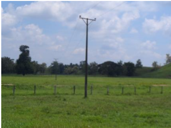
Fotografía 2- 89 Infraestructura eléctrica existente línea de media tensión.
