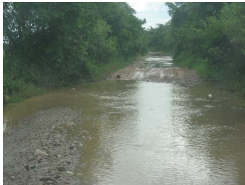
Fotografía 2.23. Sectores donde la vía se encuentra en regular estado debido a la falta de drenaje que genera apozamientos de agua.
