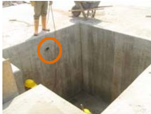
Fotografía 2.46. Tubo metálico de 6'' instalado por debajo de la placa del taladro para instalaciones eléctricas.
