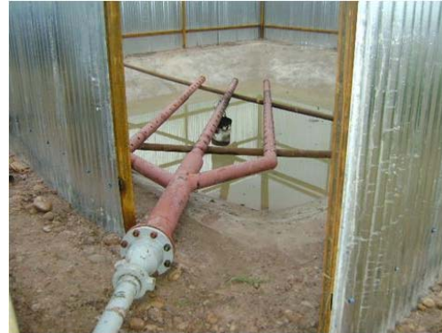
Fotografía 2.71 Quemador con mampara de protección
