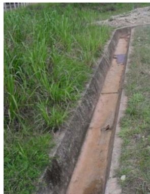
Fotografía 2.69 Canal Perimetral en la Localización
