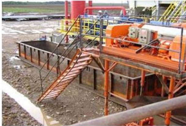
Fotografía 2.65 Equipo del Sistema de Control de Sólidos
