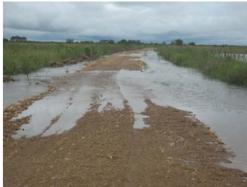
Fotografía 2.18. Sectores de la vía donde el agua de escorrentía cruza por encima de la calzada por deficiencia en las estructuras de drenaje.
