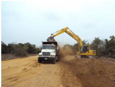
Fotografía 2.35. Se observa la actividad de corte de la zona de préstamo lateral en un tramo de vía y su transporte al punto de acopio en volqueta.
