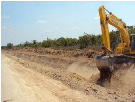
Fotografía 2.36. Corte sobre la zona de préstamo lateral. Se observan las dimensiones tipo de la excavación.
