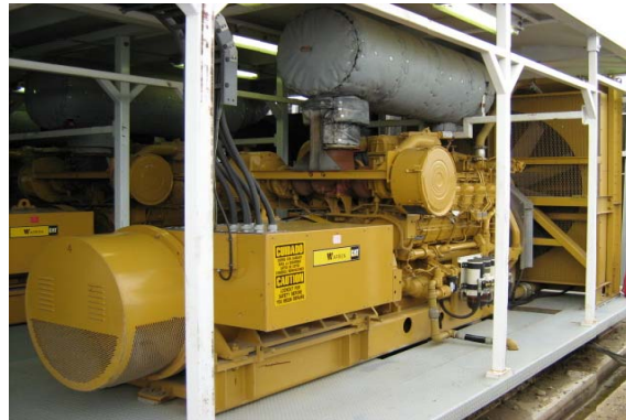
Fotografía 2.61 Generadores de Potencia
