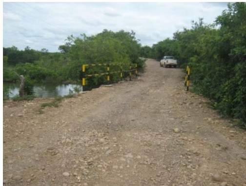
Fotografía 2. 6. Puente sobre el caño Bujumena que debe ser analizado para definir su resistencia.
