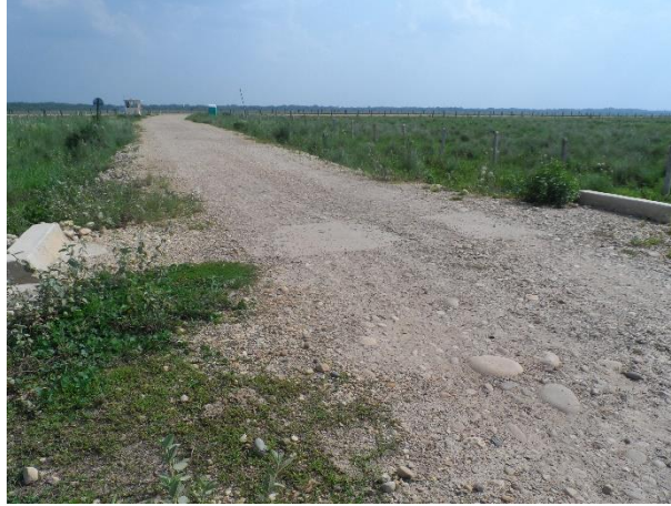
Fotografía 2-10 Estado de la vía V8 Coordenadas E: 1296567 , N: 1119020
