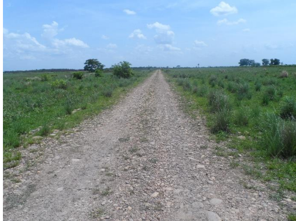
Fotografía 2-9 Estado de la vía V7 Coordenadas E: 1296027, N: 1120187
