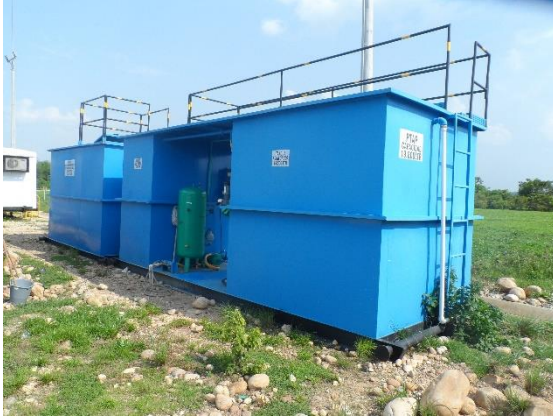
Fotografía 2-26 PTAP (Tratamiento de agua)
