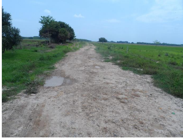
Fotografía 2-5 Estado de la vía V3 Coordenadas: E: 1285682, N: 1123988
