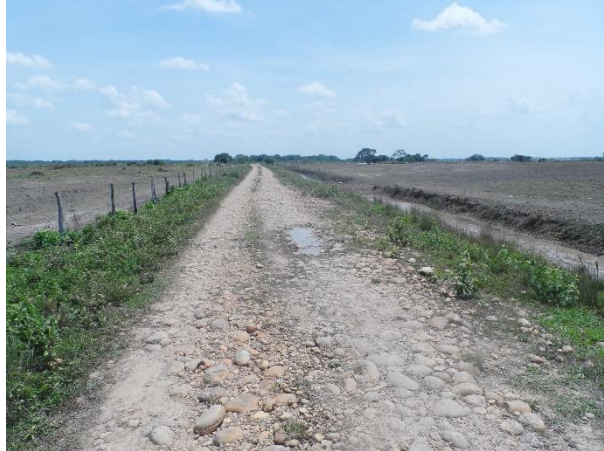
Fotografía 2-8 Estado de la vía V6 Coordenadas E: 1295182, N: 1119733
