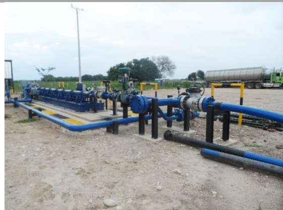
Fotografía 2-25 Bombas de transferencia
