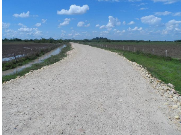
Fotografía 2-6 Vista del estado de la vía V4 Coordenadas E:1289751, N: 1122394
