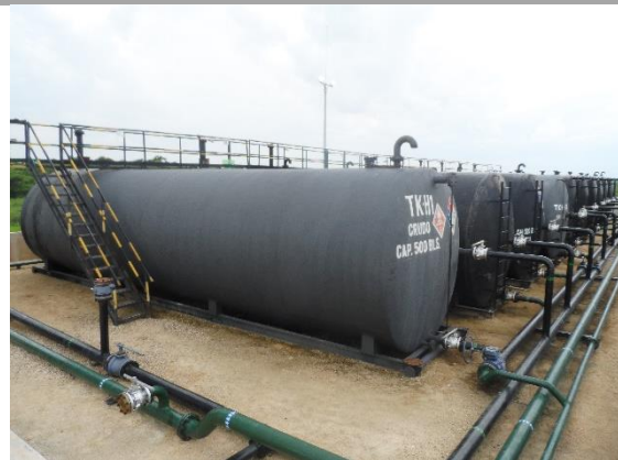
Fotografía 2-23 Tanques de almacenamiento
