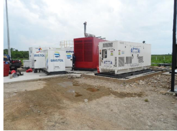
Fotografía 2-27 Generador de energía
