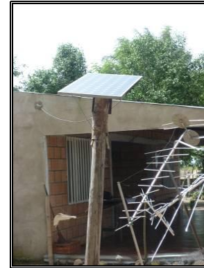
Fotografía 2- 23: Panel solar ubicado en vivienda de la vereda Rincón Hondo, municipio de Paz de Ariporo.
