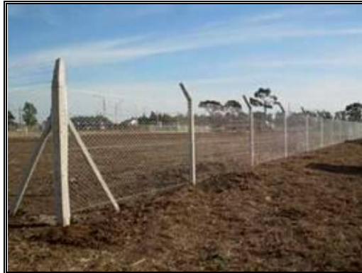
Fotografía 2- 60: Cerramiento con alambre de púas para aislamiento y seguridad de las plataformas.
