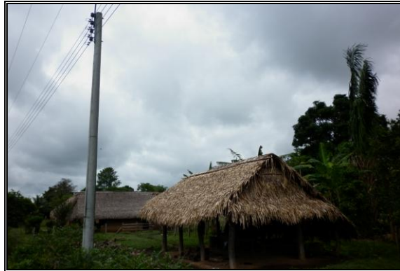
Fotografía 2- 22: Tendido eléctrico al interior del Bloque LLA 40, vereda Rincón Hondo, municipio de Paz de Ariporo.
