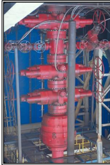
Fotografía 2- 57: Válvulas preventoras, BOP's
