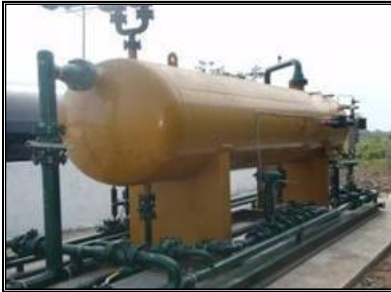
Fotografía 2- 62: Separador trifásico horizontal.
