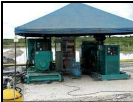
Fotografía 2- 66: Sistema de generación de energía.
