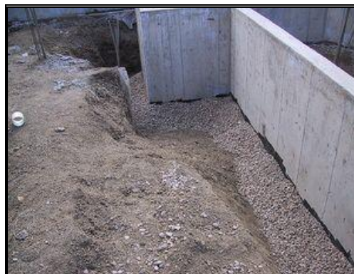
Fotografía 2- 47: Muros de contención estándar para tanques.
