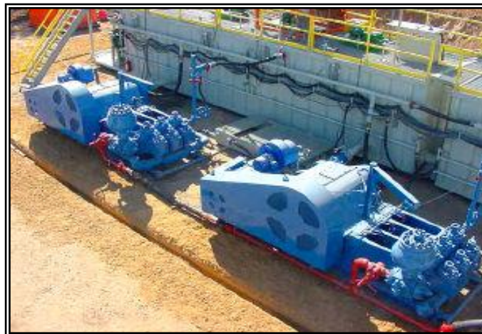
Fotografía 2- 55: Bombas de lodo.
