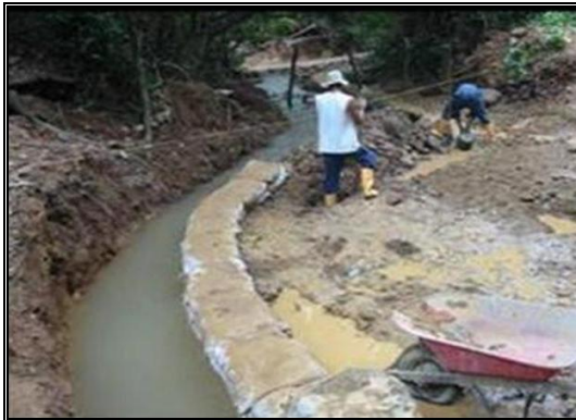
Fotografía 2- 29: Construcción de un canal para el desvío temporal del flujo del cuerpo de agua.
