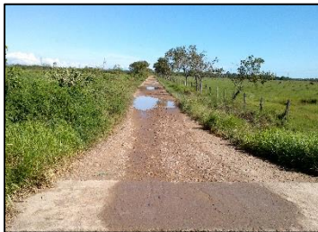
Estado de la vía 6. E: 5003267,561; N: 2006894,717
